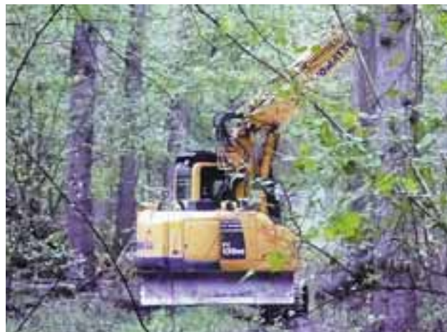
Schweres Gerät in der Geithe hat die Wege zerstört.
